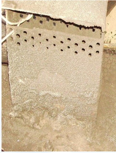
CJST塔板使用3个月后
